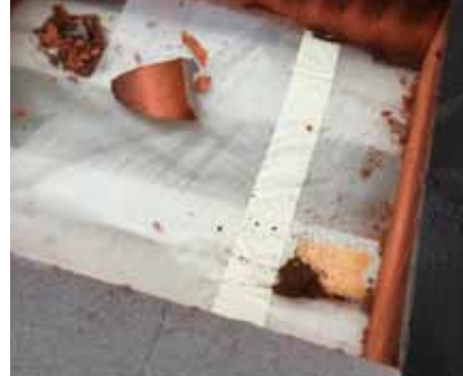
De resten van een bevestiging blijven achter op de dampremmende laag.
