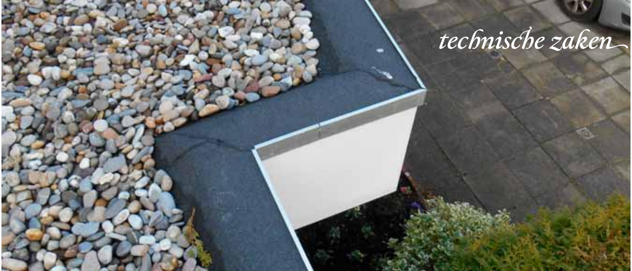
Dakrand met daktrim: zo moet 't niet!
